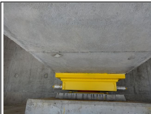
거더 S1 매립부 콘크리트 들뜸
