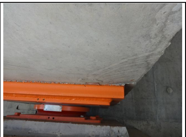
거더 S1 매립부 콘크리트 들뜸
